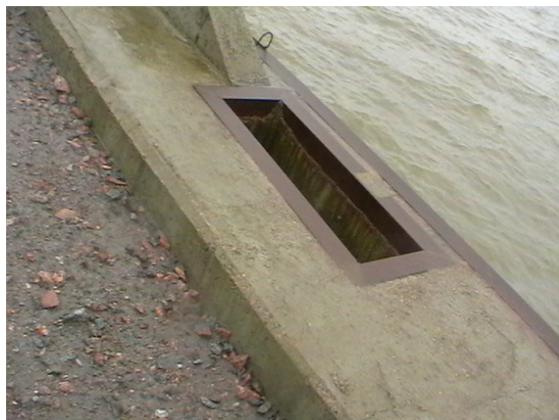
Фото 2. Ниша в теле причала для возможной установки датчика уровня и водомерной рейки.
