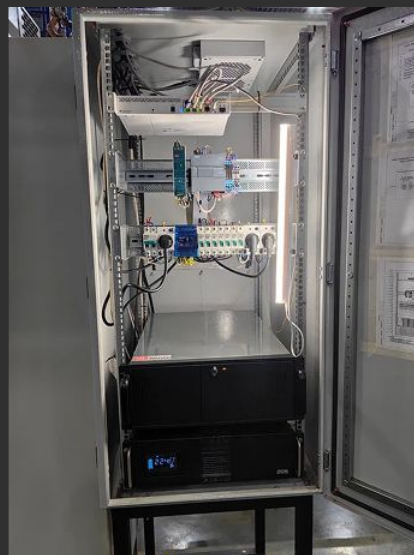
Пыле-влажностезащищенный серверный шкаф
